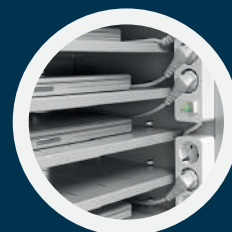
Organització elèctrica amb regletes de preses schuko
